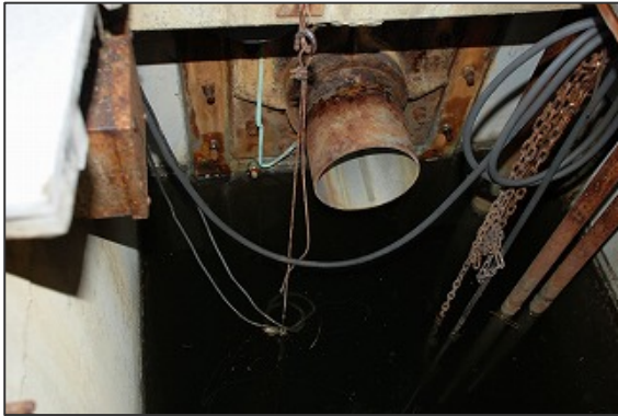
写真-5 流量調整槽（硫化水素）
