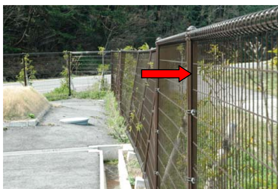
写真-11 場内フェンスの倒壊
