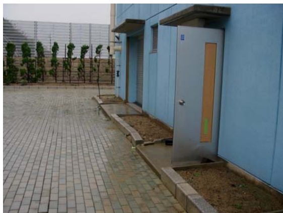
写真-15 場内施設（境界ブロック）の一部不陸
