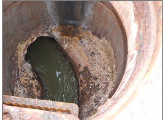
写真-1 微生物腐食をうけたマンホール
