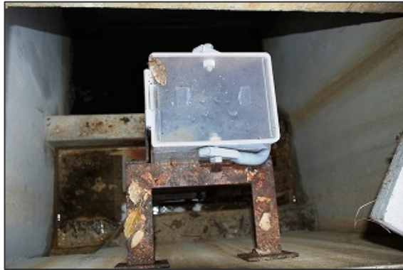
写真-6 消毒槽サポート（塩素）
