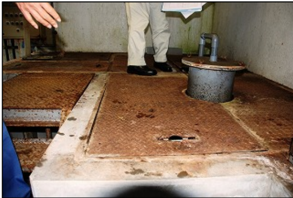
写真-7 前処理部点検蓋（硫化水素） （硫化水素）
