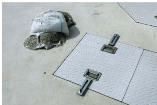
写真-12 点検蓋の飛散対策の事例
