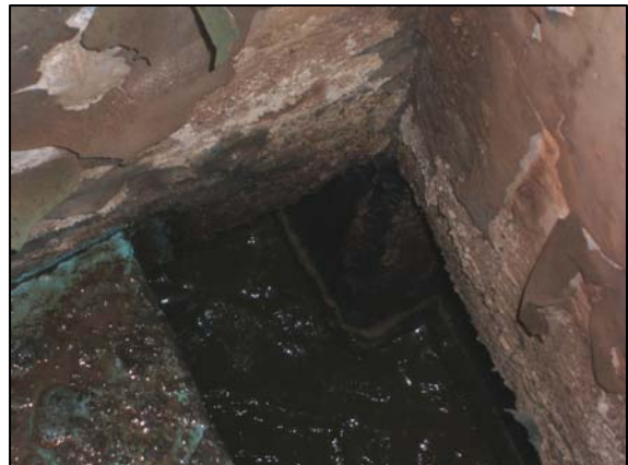
写真-2 水槽躯体ライニングのはく離
