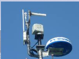
レーダーアンテナ装備状況
