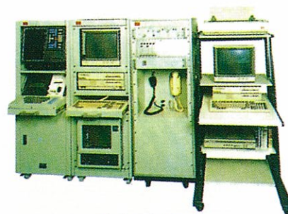
陸上監視局 無線による管理システム
